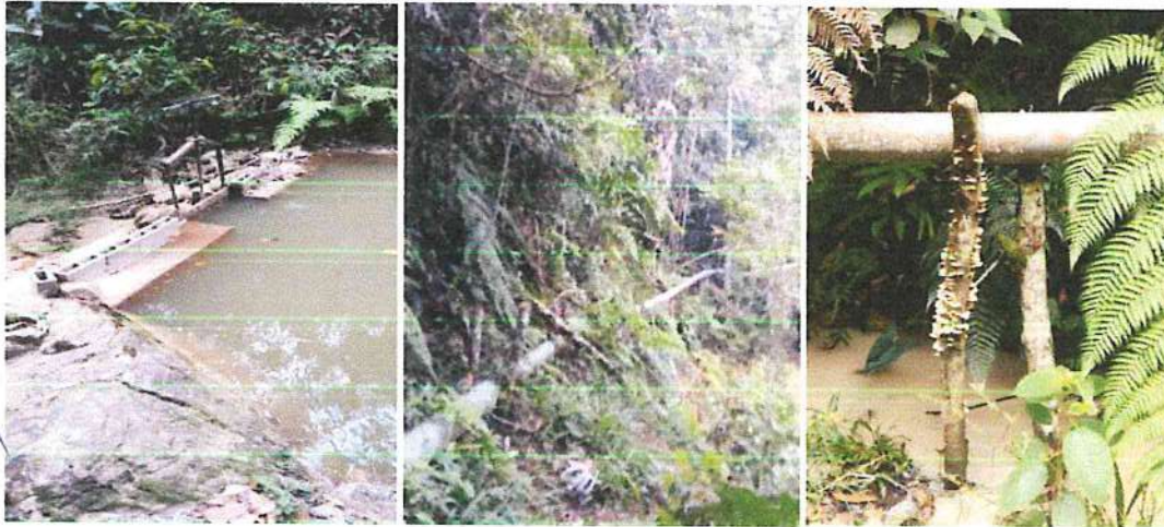
Captación El Milagro y el estado de la línea de conducción
