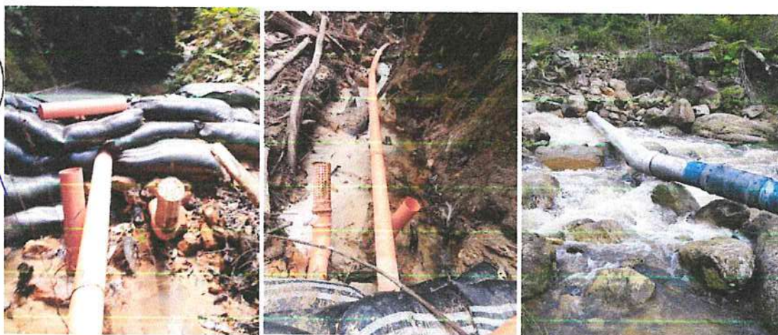
Captación Chuyayacu y el estado de la línea de conducción
