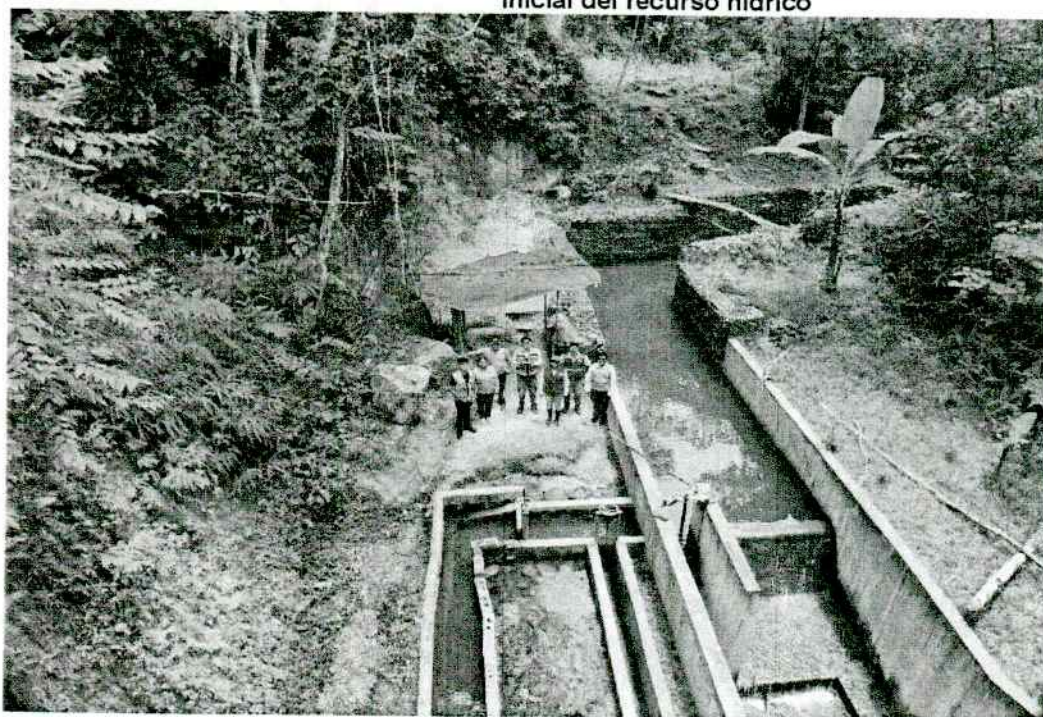
Foto N°23: Infraestructura hidráulica utilizada para la captación y conducción inicial del recurso hídrico
